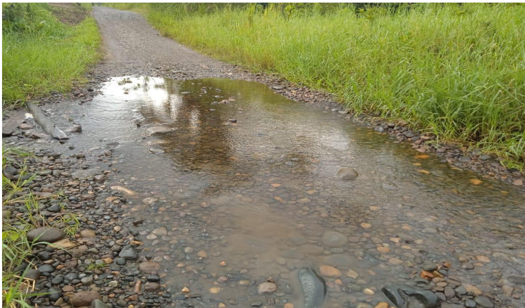
Figura 73 Imagen de vía de rodadera en Ávila Huiruno
